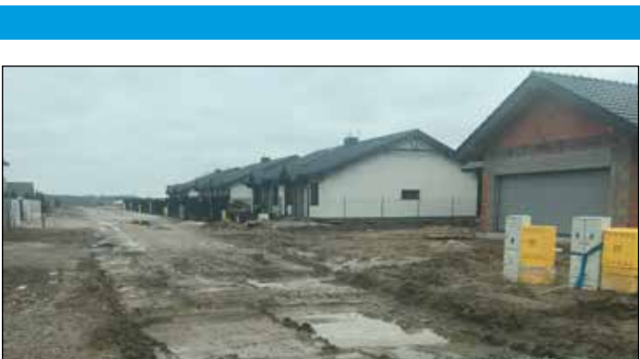
Wymina podbudowy na uszkodzonym odcinku drogi gruntowej
