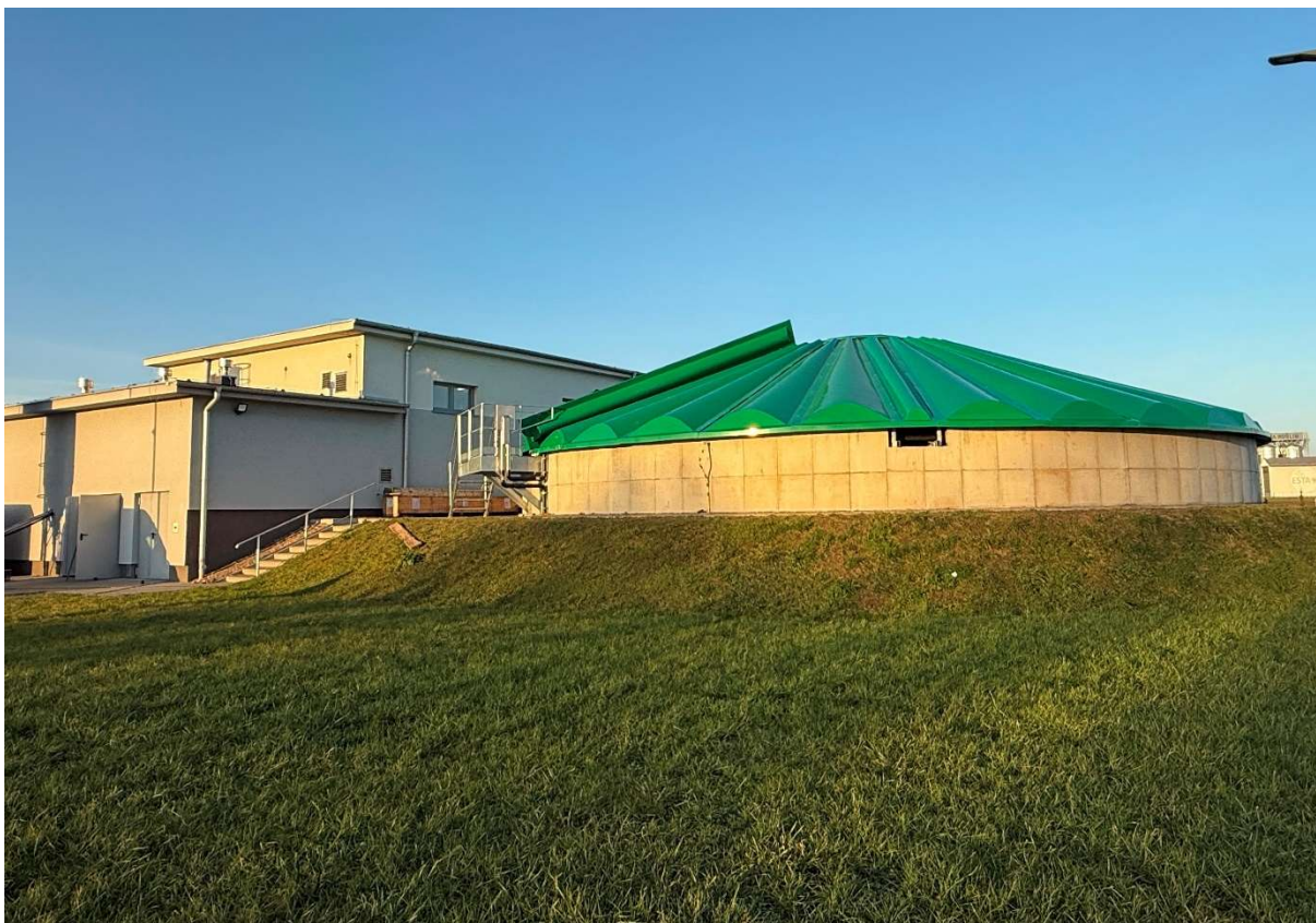
Fot. Drugi reaktor oczyszczalni ścieków w Nagradowicach
